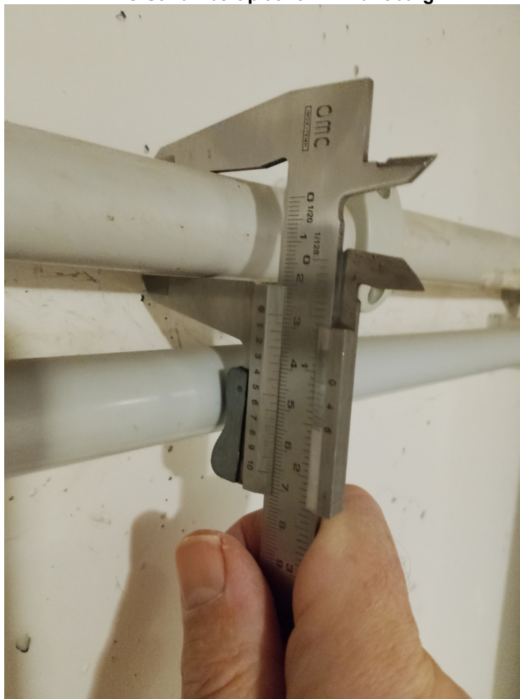
IMG_20251217_104312 // Hauptleitung zwischen HA-Kasten und Zählerverteilung
