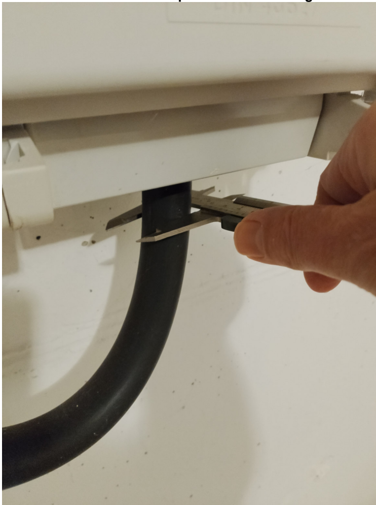
IMG_20251217_104207 // Hausanschlusskabel 27,2mm von Waskönig+Walter (möglicherweise NYCWY 4x25)
