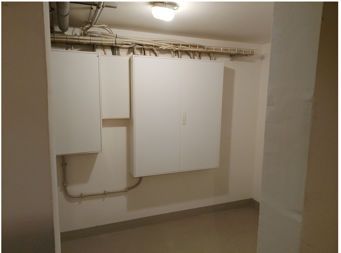
IMG_20251217_123250 // beide Zählerschränke im UG (rechts nur Wohnungszähler)
