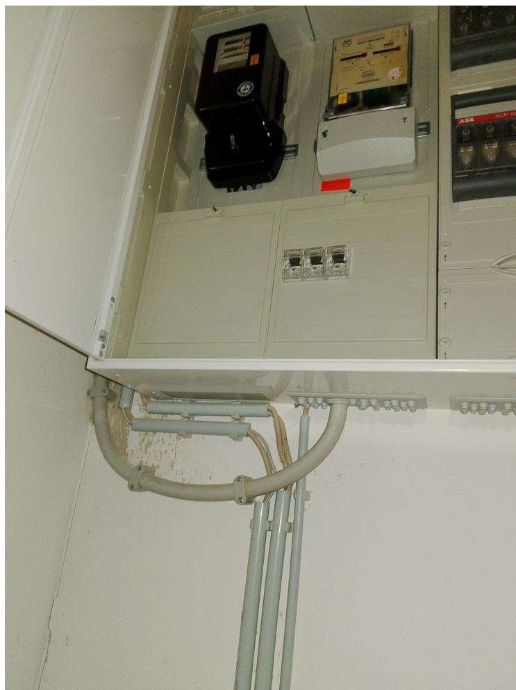
IMG_20260624_131137 // Einführung des Hauptkabels in die Verteilung
