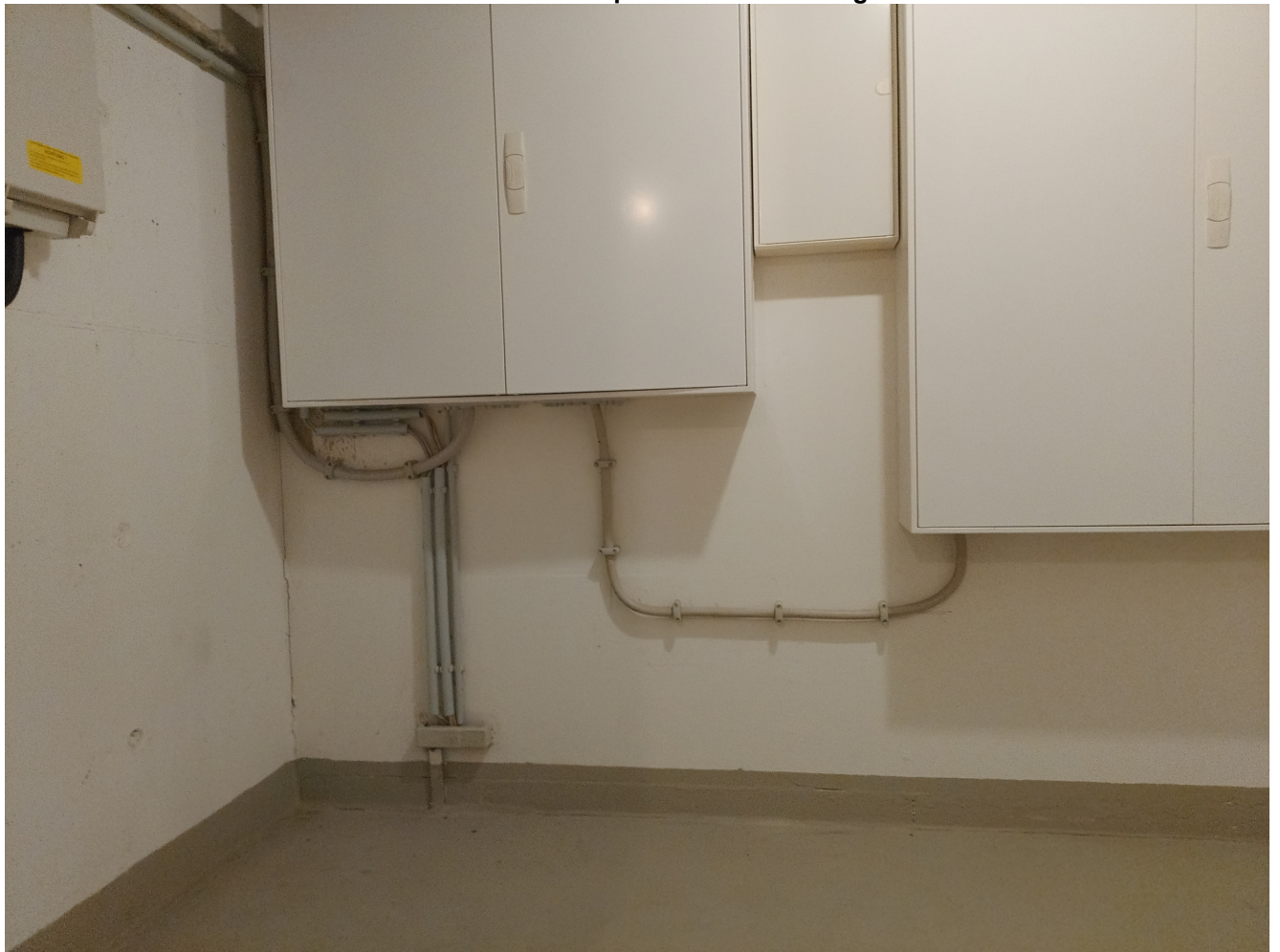
IMG_20251217_123233 // Zählerverteilung im UG (es gibt eine weitere Zählerverteilung in einem anderen Raum; die hängt auch an der hier sichtbaren, linken Hauptverteilung)
