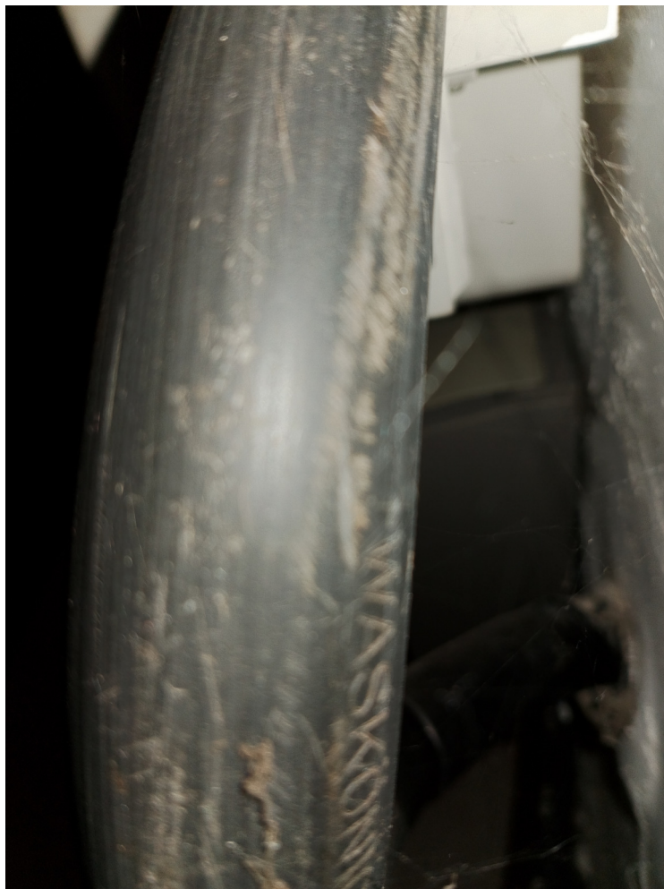
IMG_20251217_124350 // Hausanschlusskabel von Waskönig+Walter
