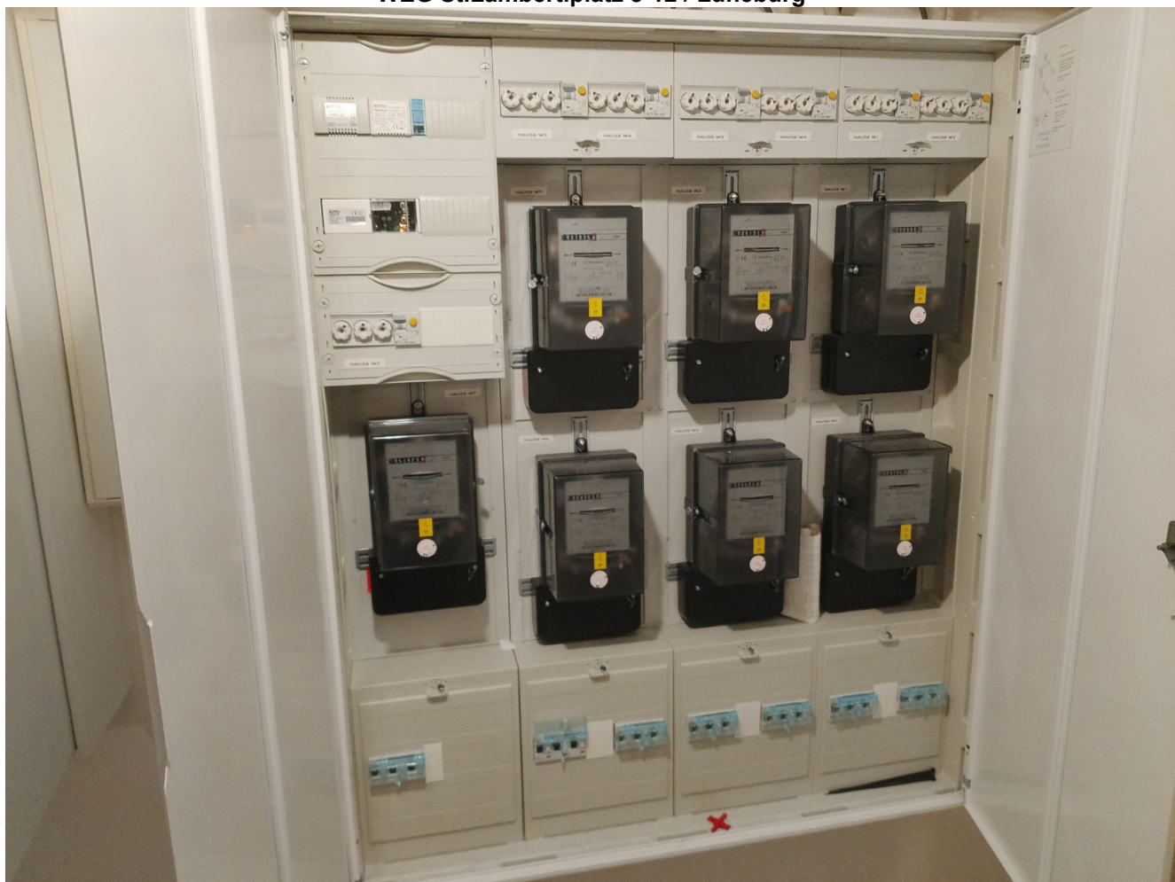
IMG_20260624_131449 // nur zur Info: rechts neben der Hauptverteilung ist diese Zählverteilung angeordnet
