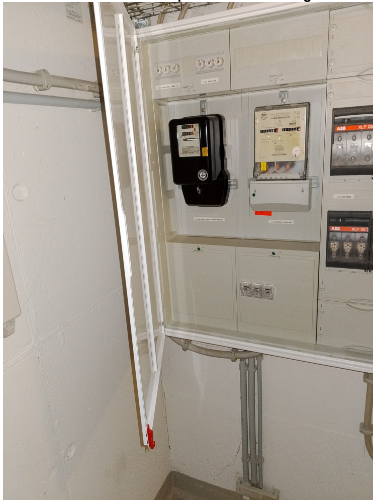
IMG_20251217_123513 // Hauptverteilung und unten links Einführung des Hauptkabels
